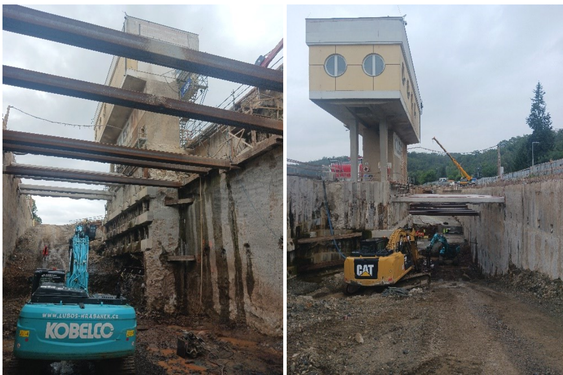
Obrázek 5 a 6: Stavební jáma při stavbě MVE Klecany II s pohledem na velín jezu
