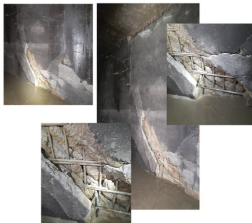
Obr. 15: poškodenie nosného múru výtokových kanálov 2 a 3
