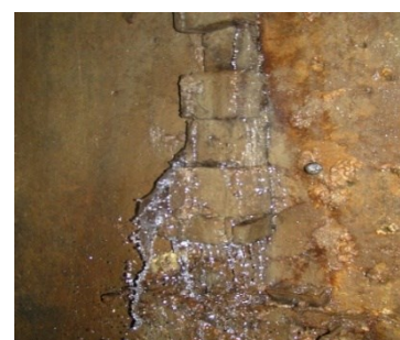
Obr. 12: Pôvodná lokálna sanácia netesnej dilatácie
