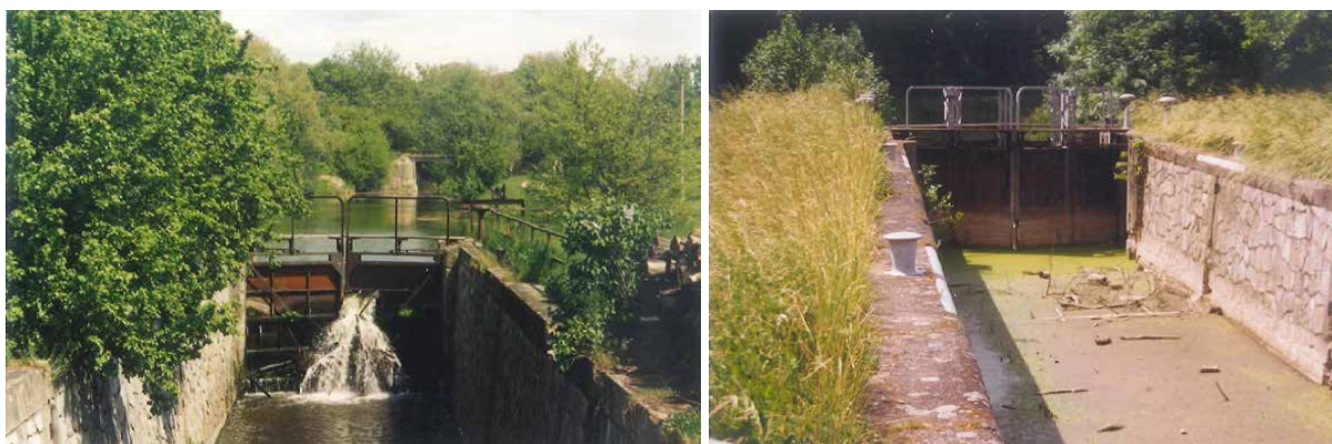
Obr. 4 a 5: Nefunkční vodní cesta
