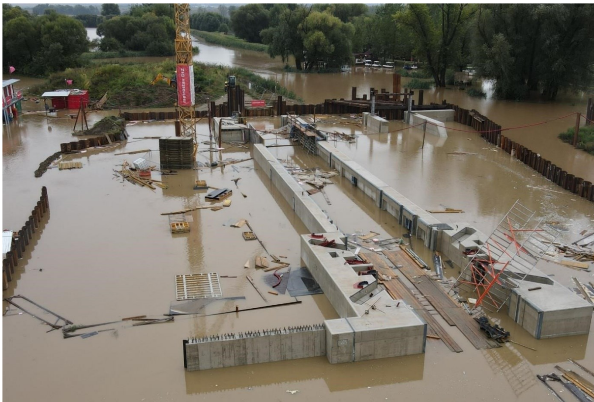
Obr. 10 Zaplavená jímka při povodni 09/2024 (zdroj: Metrostav DIZ s.r.o.)
